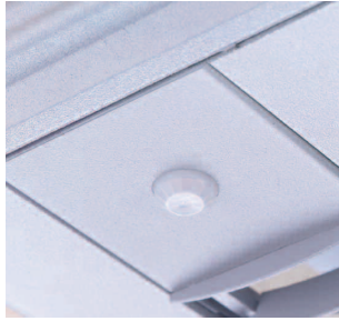
-NS1 , Armaturen kan förses med närvarostyrning. Se under fliken "Teknik".
