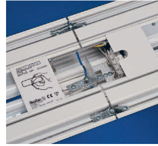
Armaturerna är rampbara. Överkopplingsatts (Ök sats).
